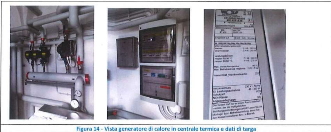
Figura 14 - Vista generatore di calore in centrale termica e dati di targa
